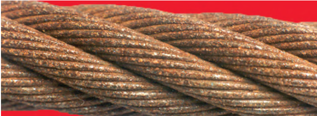
ı. Dış korozyonun yakınlaştırılmış şekli
